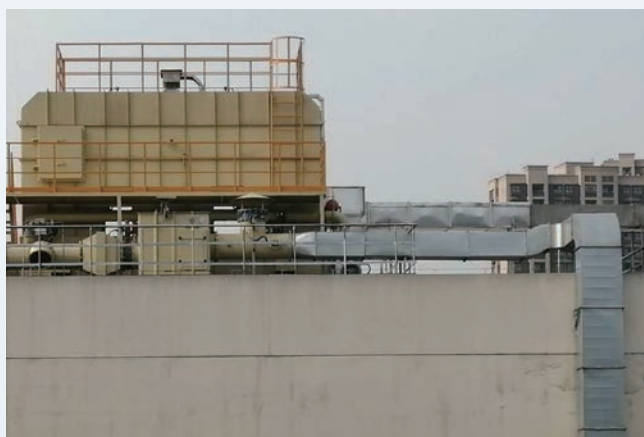
圖：卵磷脂車間廢氣處理裝置
